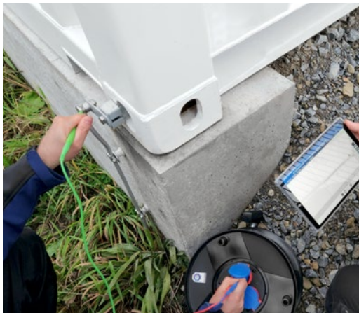
Alltag in der Installation von Anlagen: Die Qualität der Erdung wird gemessen
