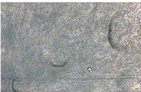
Afb. 29: Niet doorstaan level – schadebeeld blaasvorming
