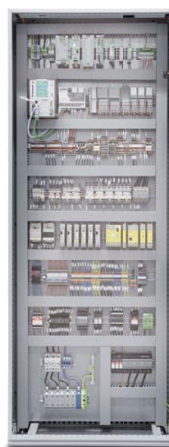
PLD制御盤用 LED照明
