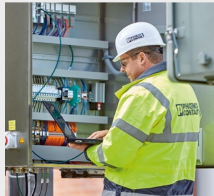
Empleo del sistema de automatización y telecontrol en la red eléctrica
