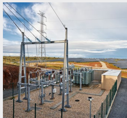
Conexión a la red con la regulación de la alimentación en la central eléctrica fotovoltaica
