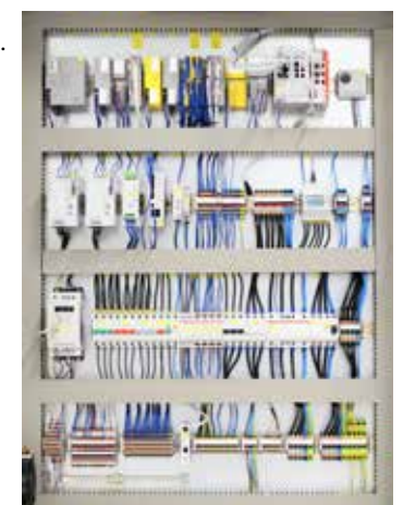
Styretavle med komplet kontrolteknologi for elektrolyse stack
