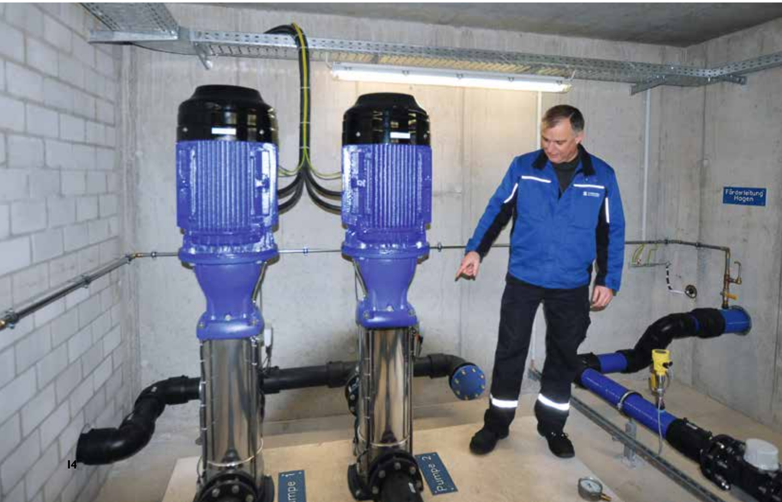
两台水泵为水箱供水
