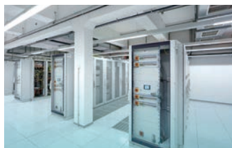
通信・データセンター
