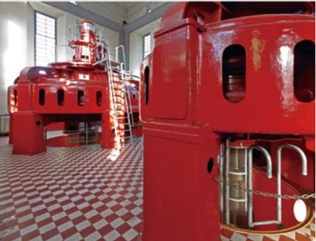
菲尼克斯电气自动化系统在德国尼德豪森 (Niederhausen) 水电厂机组监控上的应用
