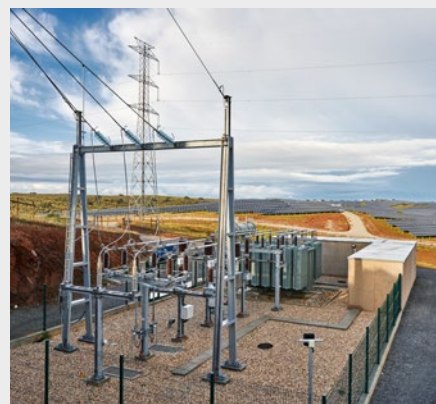
Netzanschluss mit der Einspeiseregler im PV-Kraftwerk
