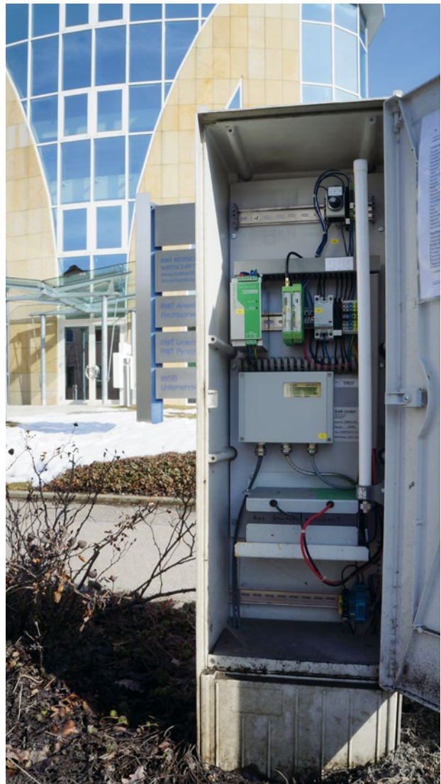
Messtation zur Erfassung der Wärmemenge an der FH Albstadt
