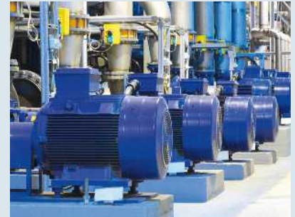
Motores y bombas en una sala industrial
