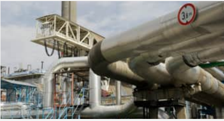
수처리 Water treatment
