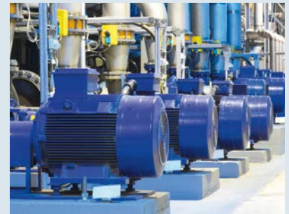
Motoren und Pumpen in einer Industriehalle
