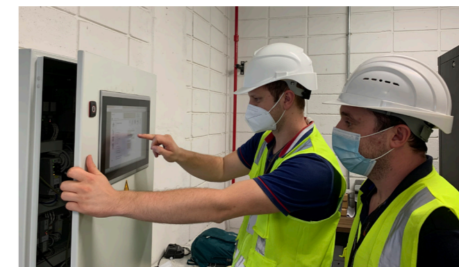
Belysningens kontrolsystem kan nemt parametres og tilpasses til kravene ved hjælp af HMI-paneler i styretavlen
