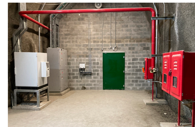
Allerede installerede Dali bokse på bagvæggen i udstyrsrummet – hurtigt installeret, pladsbesparende og nemt tilsluttet til det eksisterende netværk
