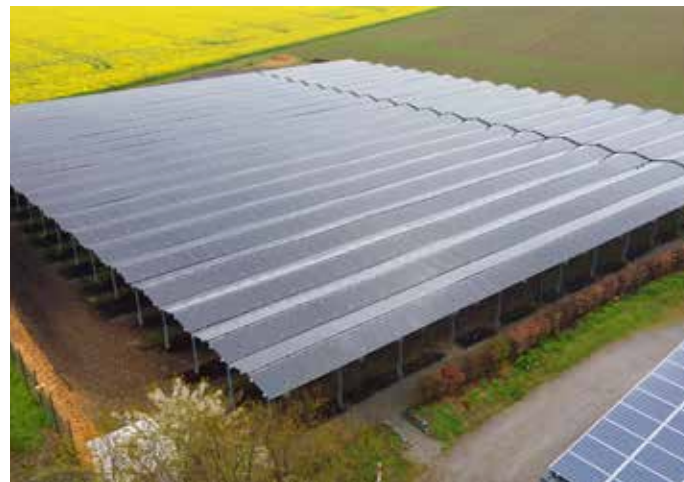
4200平方米的“温室屋顶”每年提供800000 kW/h的电力
