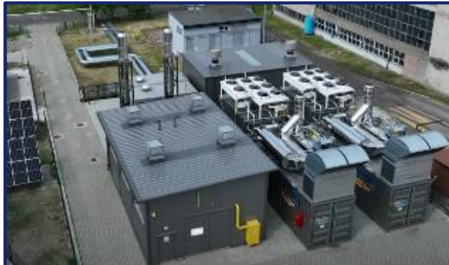
MPGK Jasło 4 MW el / 4,6 MW t
