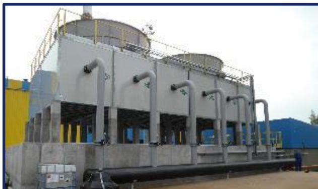
Elektrociepłownia Kielce wieże chłodnicze PMM
