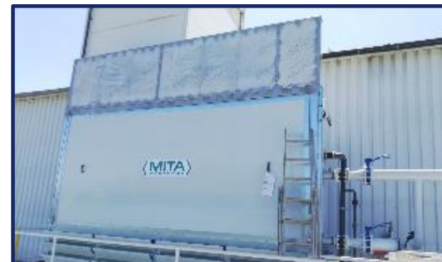
Cynk-Mal wieża chłodnicza MCC
