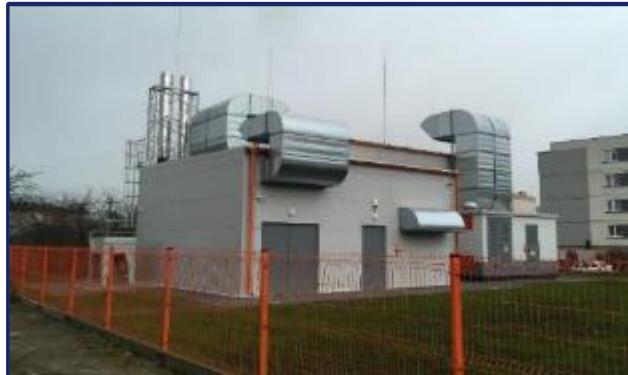
Celsius 1,5 MW el / 1,5 MW t
