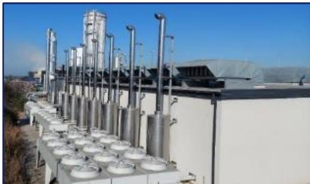
Gorzelnia (biogaz) 7 x 0,5 MW el
