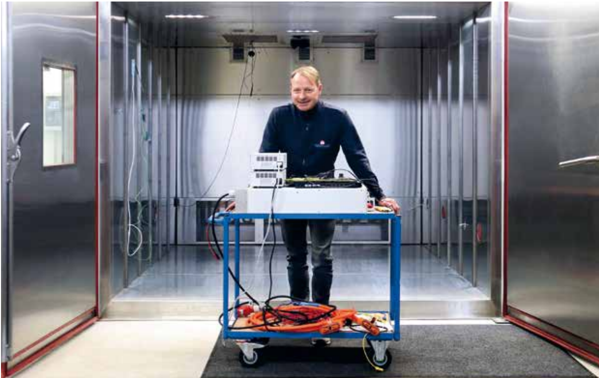
Michael Jonca yhdessä osassa akkulatoriorta, joka on rakennettu moduuleista.
