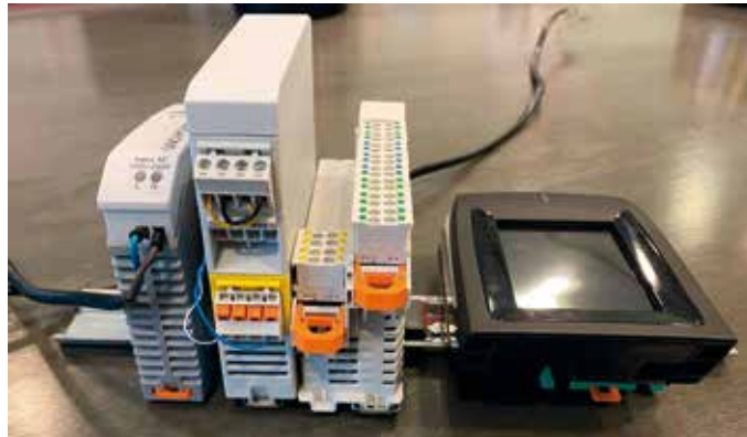
Ovipäätte, jossa vasemmalta UNO Power -teholähde, masterina ICS-kotelo, ovipäätteenä ME-IO-kotelo push-in-liittimillä, kiskossa T-Bus-väyläliittimet ja FMC-pistoliittimet. Lisäksi kuvassa on musta ovilukija.
