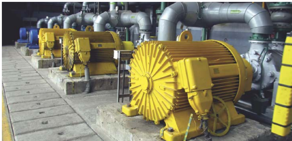
Fig. 2: I motori elettrici ad alta potenza inducono sovratensioni con elevate correnti d'inserzione
