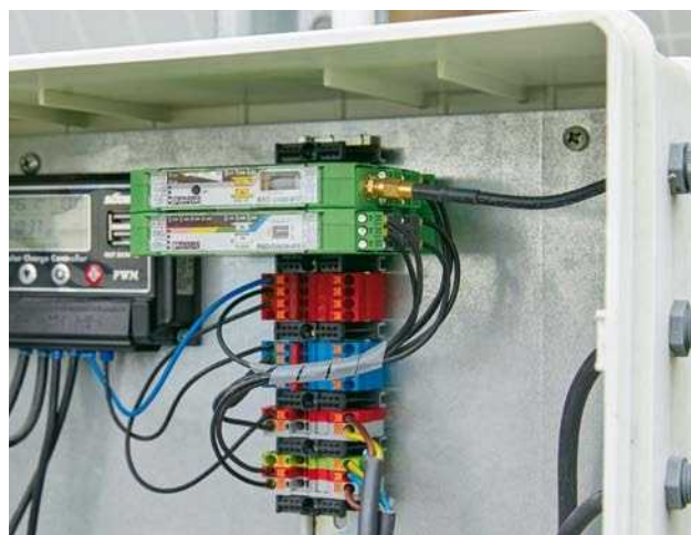
Gasdruck und Kondenswasserstand müssen permanent überwacht werden
