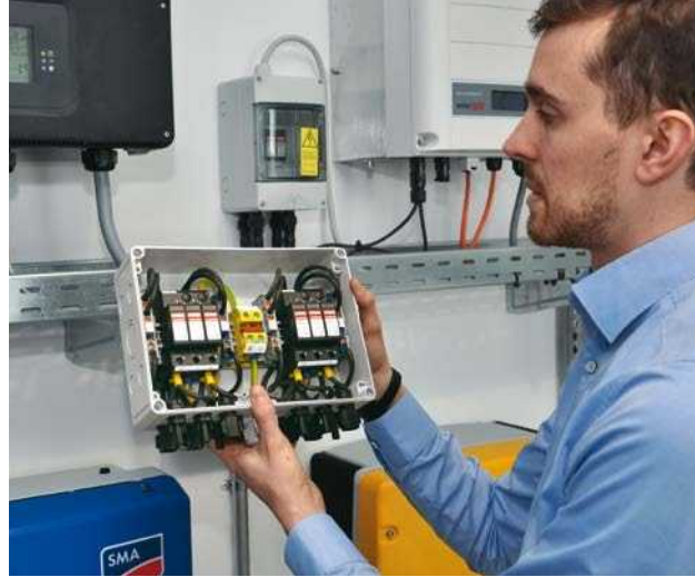
Der Wechselrichter wird durch eine PV-Box geschützt
