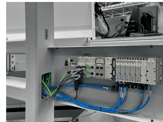
Kontaktløs kommunikation mellem PLC og Profinet ventilklemme: sensorer og aktuatorer til fastspænding af emner er forbundet hertil
